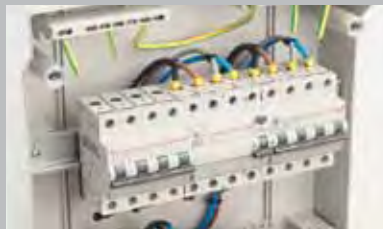
Gotowe do zainstalowania listwy zaciskowych dla połączeń N i PE Ready to install the terminal blocks for neutral and earth connection
