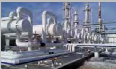
Instalacja gazu Pemex, Meksyk Gas Pemex Mexico plant Project
