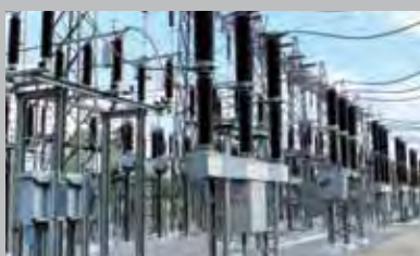
Podstacja elektryczna w Katarze, QUWC Electrical substation Qatar project QEWC
