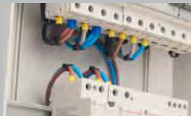
Duża przestrzeń dla okablowania Wide space for the cabling
