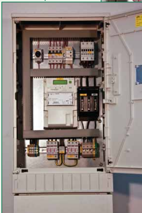
Rozdzielnica pomiarowa AC
