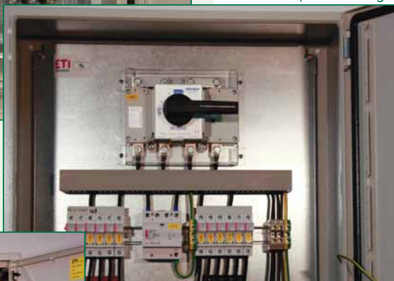
Rozdzielnica DC (wkładki CH gPV)
