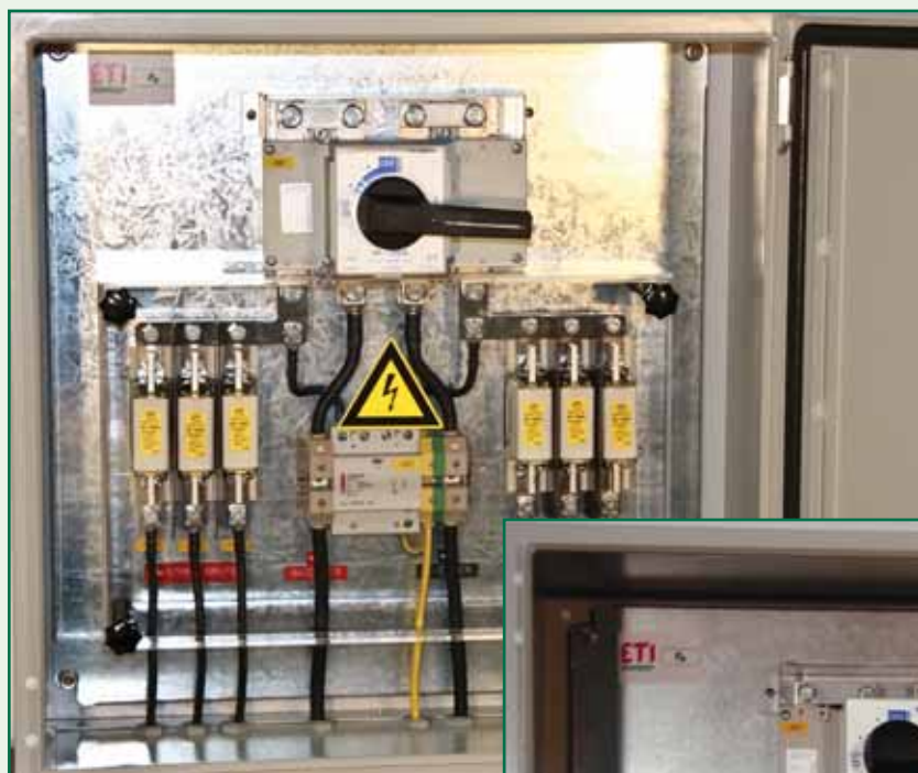
Rozdzielnica DC (wkładki NH gPV)
